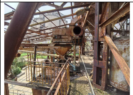
储料双罐二层设备
