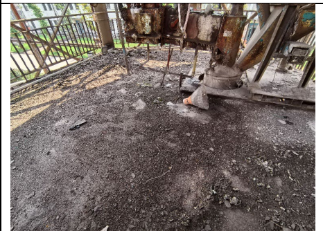
储料双罐二层平台
