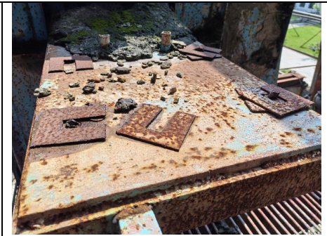
储料双罐二层设备现状
