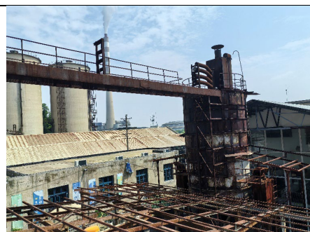
储料单罐体西侧
