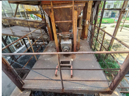
储料单罐二层钢平台
