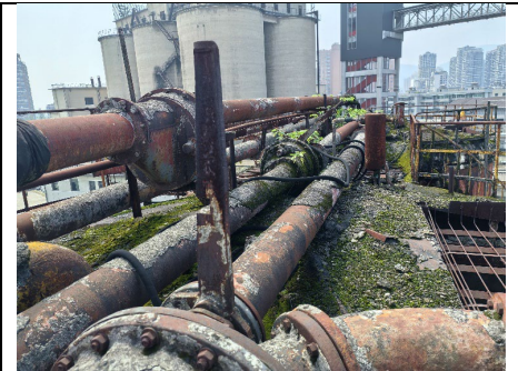
储料双罐体顶部输送管道
